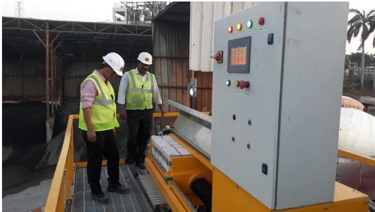
Zero Plant Discharge (ZDP) Unit
